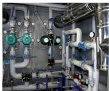
Sistemas industriais de tratamento d'água
